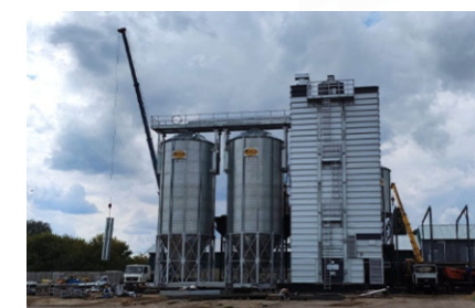
Россия, тамбовская область, инжавинский район, пос. Инжавино Зерносушильный комплекс с зерносушилкой Strahl-FR5000
