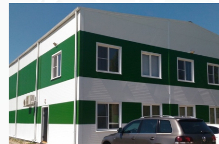
Саратовская область, Балашовский район, г.Балашов. Строительство склада для сельскохозяйственной химии и офисным помещением.
